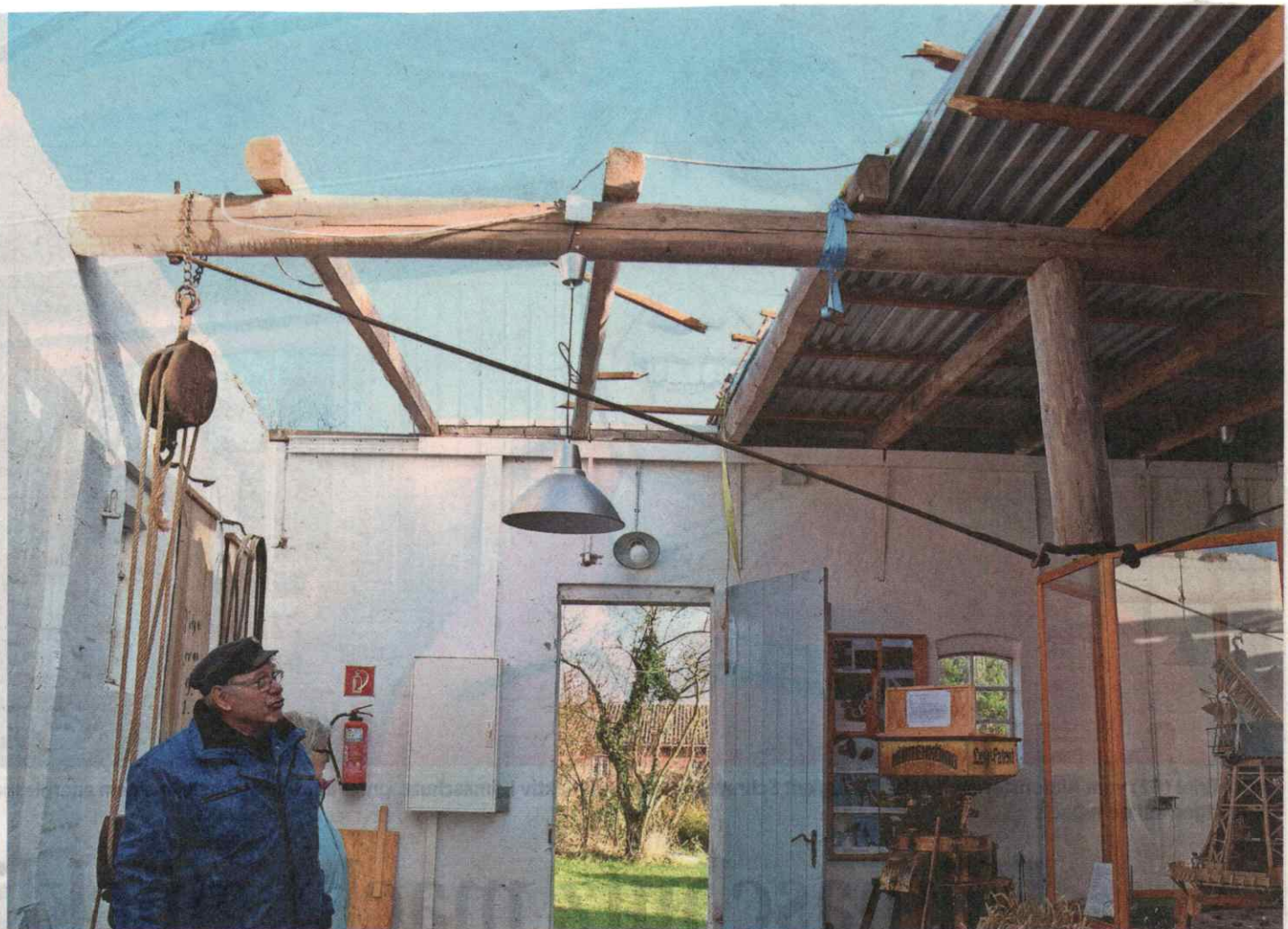
Der Sturm hat die Dachkonstruktion vom Magazin des Krokauer Mühlenvereins angehoben, so dass sich das Blechdach aufgewickelt hat. Mühlenwart Peter Stoltenberg besieht sich den Schaden nach der Sturmnacht.
